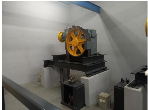
De liftaandrijving is niet asbestverdacht (bouwjaar: 2005).
