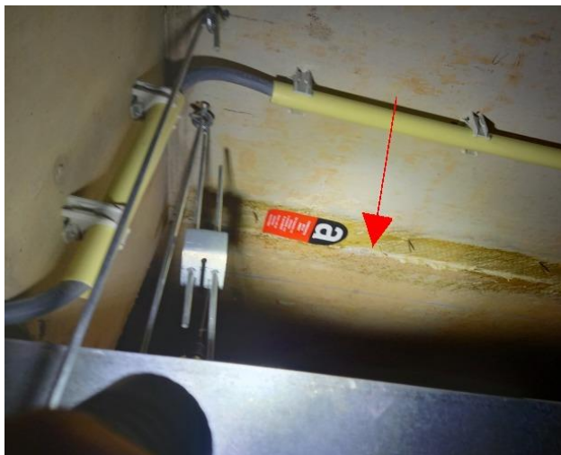
Stortstrook gemarkeerd met asbeststicker
