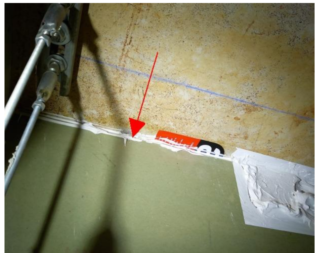
Stortstrook bevindt zich achter de gipswand
